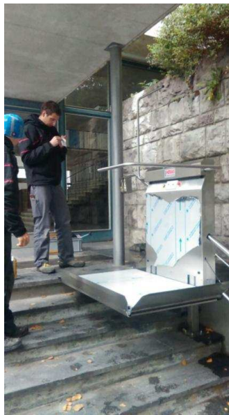
Photo 1 : plateforme élévatrice mécanisée au collège du Béthusy
