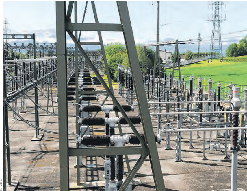
Les postes de couplage sont isolés à l'air, c'est pourquoi ils sont si volumineux. Ils vont peu à peu disparaître au profit d'appareils isolés au gaz, plus petits et plus sûrs.
