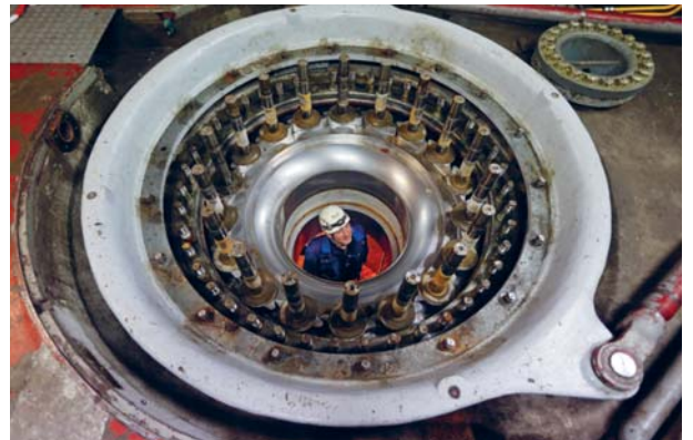
A l'intérieur de la turbine – Centrale électrique de St-Léonard, Sierra
