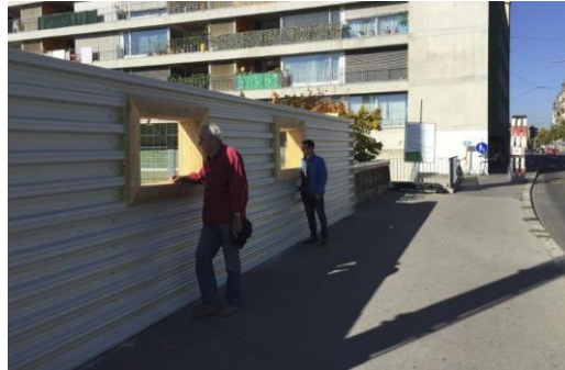
Figure 2 : Ouvertures dans la palissade de chantier du Tunnel du LEB au Parc de la Brouette
