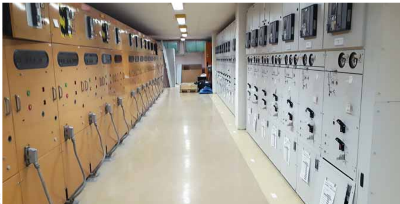
A gauche, une rangée de cellules moyenne tension attend d'être remplacée par une neuve comme celle de droite.
