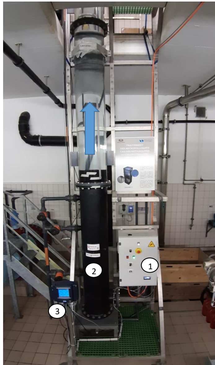
Figure 39 : Pilote Opacarb® FL, (1) coffret électrique, (2) bas de la colonne du pilote contenant le charbon, (3) moniteur permettant de consulter les données des sondes en temps réel.
