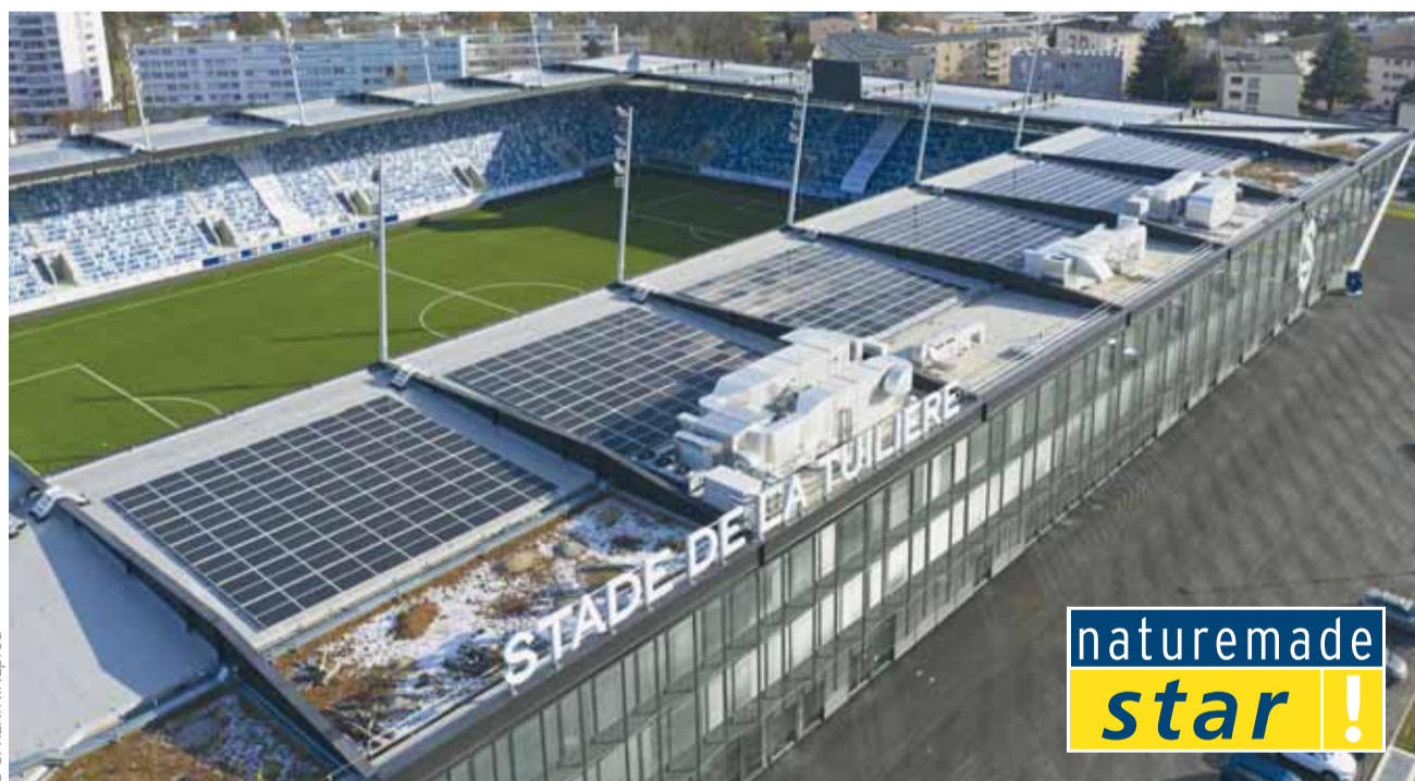
La centrale solaire photovoltaïque du stade de la Tuilière peut fournir de l'électricité pour environ 250 ménages.
